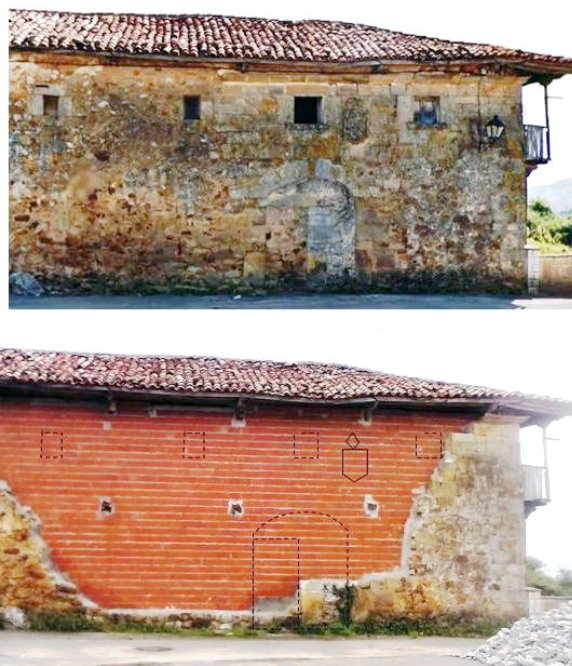
Fig. 14.- Casa en Mercadal que fue blasonada (superior) y con ese lienzo de pared caído (inferior). Google street y José I. Velarde
