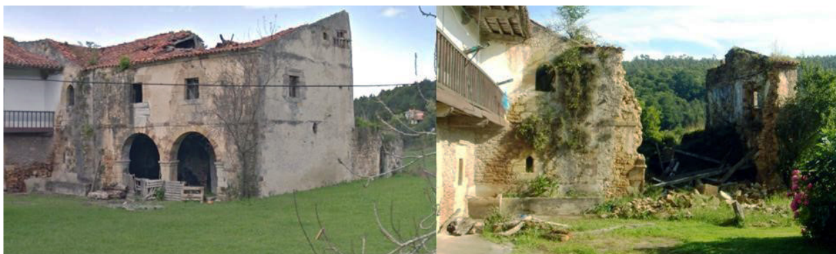
Fig. 13.- Torre y palacio de los Bracho en Ruiseñada (izquierda) y su estado en julio de 2018 después de su derrumbe parcial (derecha). Google street y José I. Velarde
